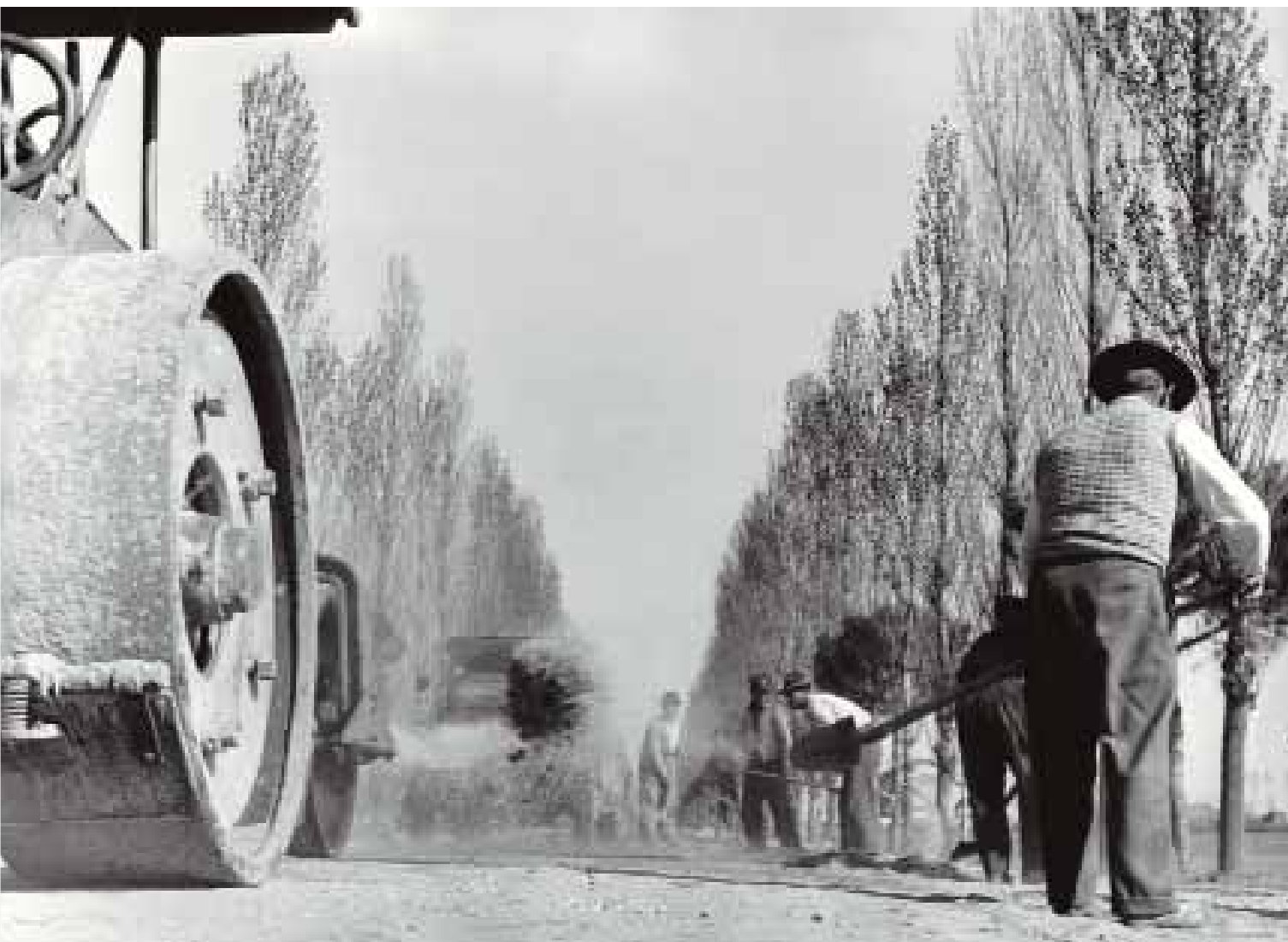
■ Lavori di bonifica nel Delta: costruzione di una strada a Massafiscaglia Reclaiming the Po Delta: a road under construction in Massafiscaglia
