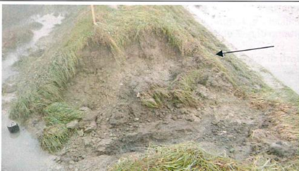
Figura 26: Danni all'argine in località la Barchetta (Campogalliano)
