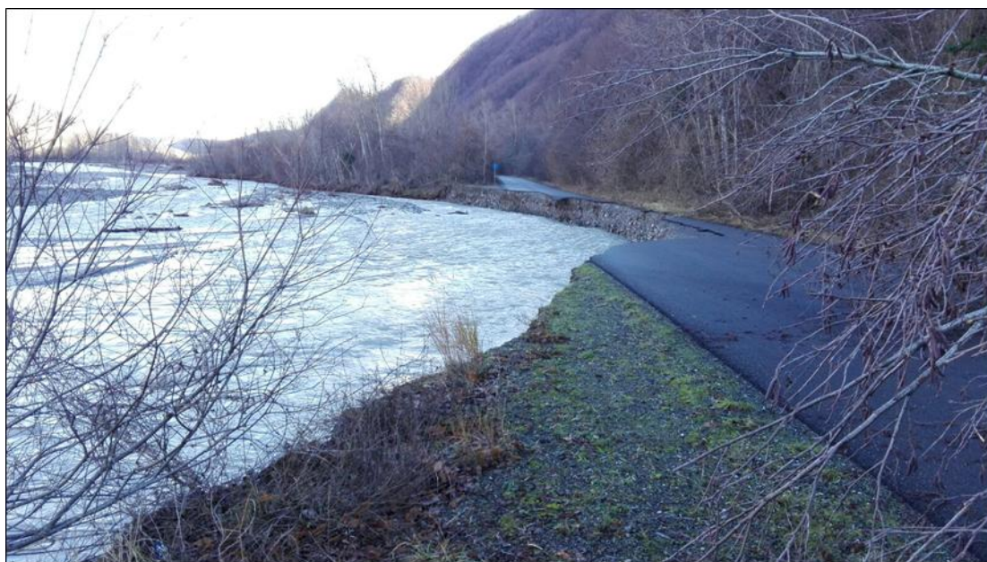
Figura 21: Danneggiamento della pista Gatta-Pianella
