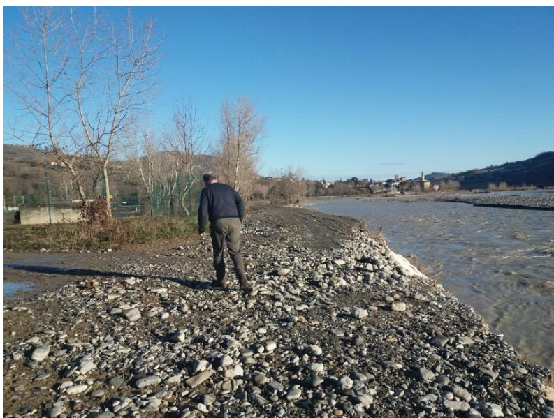
Figura 16: Erosione di sponda in corrispondenza del Pozzo acquedottistico di Travo
