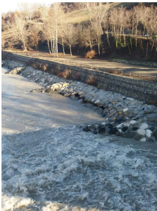
Figura 15: Erosione delle difese in pietrame in destra idraulica del Trebbia, a valle del ponte Gobbo di Bobbio.
