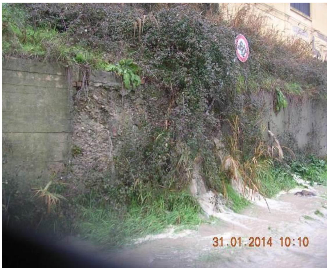
Figura 4 - Fuoriuscita di acqua durante la piena di Reno del 31.01.2014
